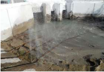
Рис. 14. Подача напорной воды к перфорированным трубам в аванкамере насосной станции Йулдош
