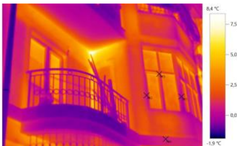
Рис.1. Термограмма фрагмента фасада с конструкцией сопряжения стены с балконной плитой
