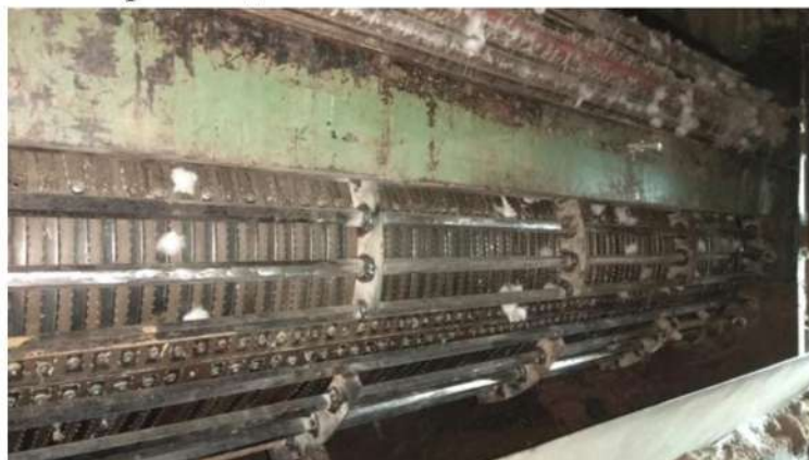
Рис. 11. Установленные шестигранные конические колосники на машине УХК
