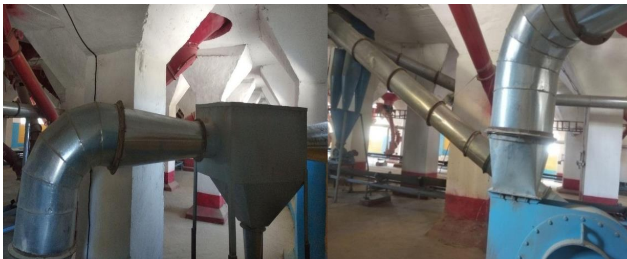
Рис.11. Внешний вид процесса контроля энергосберегающего малогабаритного пылеуловителя, установленного на производстве.
