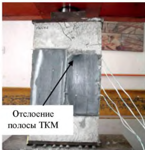
Рис. 12. Отслаивание листа ТКМ от поверхности бетона спецобразца PF3 с внешним армированием из ТКМ (передняя сторона)
