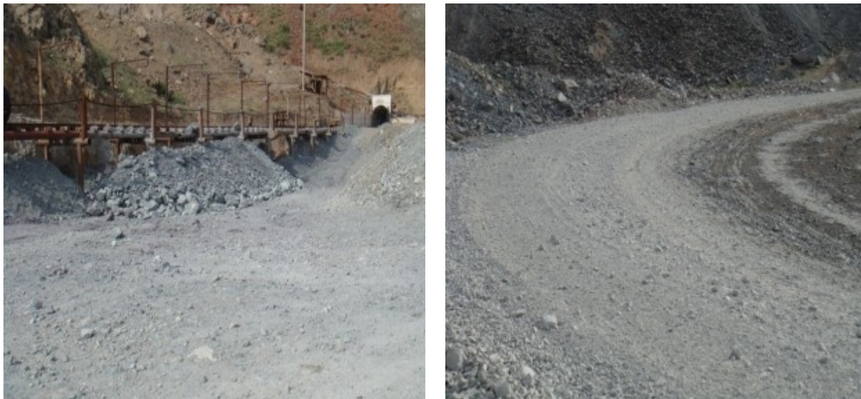
Рис.3. Состояние дороги на ЧРУ
